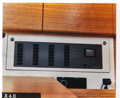
X 4.0 Vorbildliche Installation auf der Dänin mit einer gut gekennzeichneten Verkabelung
