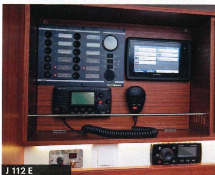
J 112 E Nur außen glanzvoll. Hinter der Instrumententafel sind die Kabel unordentlich verlegt
