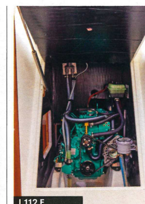
J 112 E Wenig Platz, kleine Luken. Die Maschine ist für Wartung nur eingeschränkt erreichbar
