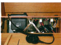
DUFOUR 310 Die elektrische Verkabelung ist unübersichtlich verlegt und auch nur schlecht zugänglich
